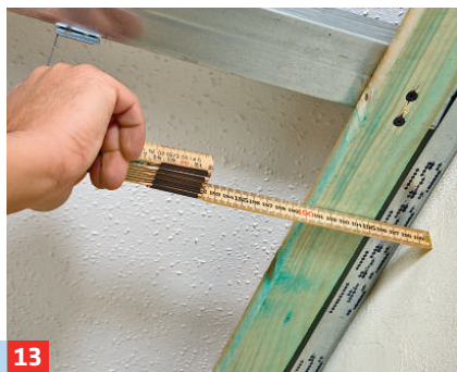
13 Die erste Latte parallel zum Wandabschlussprofil setzen. Dabei berücksichtigen, dass die Latten über die ...
