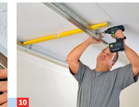
10 Bei der Befestigung der weiteren CD-Profile stets mit Wasserwaage ein gleiches Höhenniveau sicherstellen.
