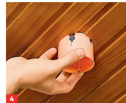
4 Die elektrischen Leitungen verlegt man wunschgemäß unter der Decke.
