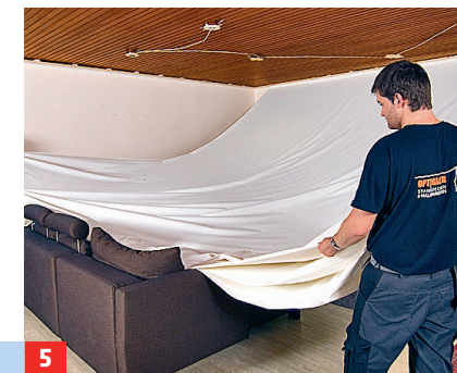
5 Das spezielle Spanndeckentuch entfaltet man, es ist werkseitig auf die notwendige Raumgröße vorgeschritten.
