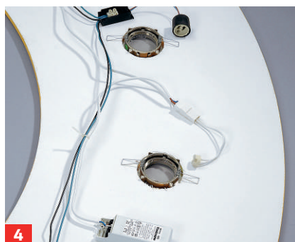
4 Werden die Kabel mit etwas Abstand zum Rand der Konstruktion verlegt, sind sie später nicht sichtbar.
