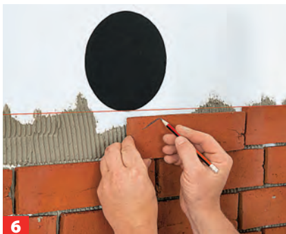
6 Nötige Ausschnitte wie hier am Rauchrohr eines Kaminofens mit einem Bleistift am Riemchen anzeichnen.
