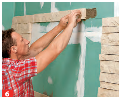
6 Die Verblender entlang der Markierung verkleben. Die Steine sind modular, man kann sie auch unterschiedlich versetzt ...
