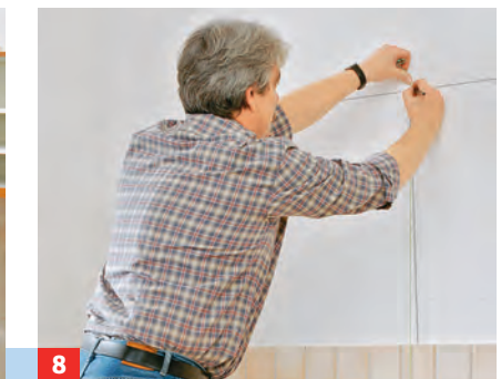
8 Da in diesem Fall ein etwas tieferer Korpus für die Abzugshaube montiert wird, loten Sie die Montagepunkte ...
