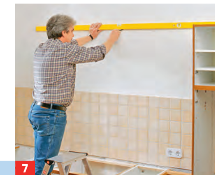
7 Vom Besenschrank wird nun das Höhenmaß für die Hängeschränke waagrecht auf die Wand übertragen.
