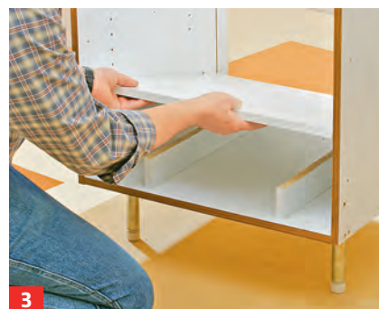
3 Der Korpusboden wird aufgedoppelt, so dass der Einbauherd perfekt in den verbleibenden Raum passt.
