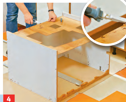
4 Wenn die Schrank-Rückwände wie hier für Installationen ausgeschnitten wurden, tauschen Sie sie aus.
