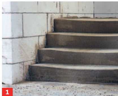
1 Eine schlecht gegossene, unebene oder ausgetretene Treppe kann problemlos ausgeglichen werden.
