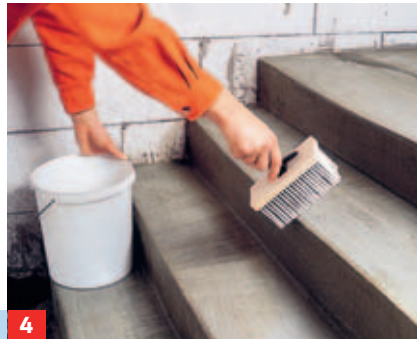
4 Zur Verbesserung der Haftung nassen Sie die Treppe mit Wasser und einem Quast gründlich vor. Die eigentliche ...
