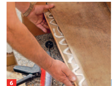
6 Die Untertrittsverkleidungsleiste mit Kleber andrücken und die Stirnseiten vernageln. Nun für jede Stufe ...
