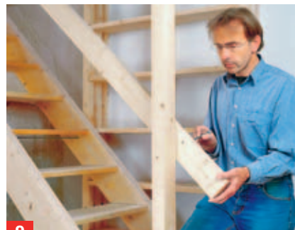
9 Laut Bauaufsicht müssen Sie zudem aus Sicherheitsgründen einen Handlauf am Treppenrand montieren.
