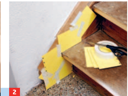
2 Mit Papierschablonen können Sie die benötigten Maße der Stufen und Wangenteile genau ermitteln.
