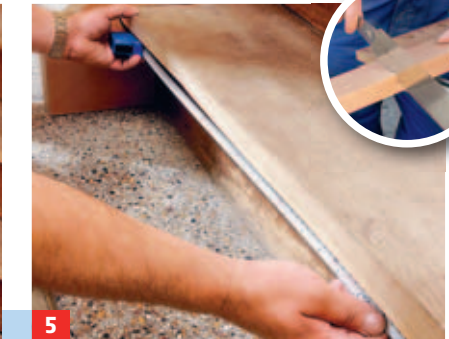
5 Messen Sie die Tiefe und Länge des Untertritts aus und sägen Sie dann die Untertrittsverkleidung zu.
