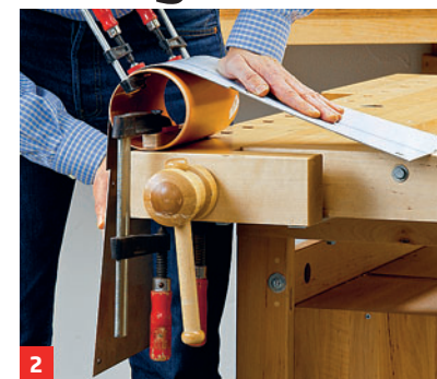
2 ... hier zum Beispiel über einem 110 mm-Abwasserrohr
