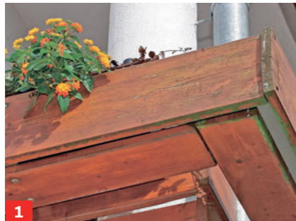
1 Gut erkennbar: An den Unterkanten haben sich bereits Algen angesiedelt
