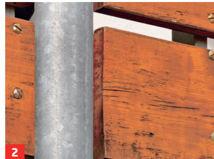
2 An Rissen ist Wasser eingedrungen, das Holz beginnt zu vergrauen
