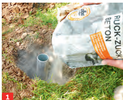
1 Betonieren Sie das Rohr ein. Dazu Estrichbeton anmischen oder Ruck-Zuck-Beton schichtweise abwechselnd mit ...
