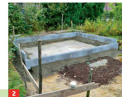
2 Im Zementbett verlegte Betonsteine dienen als Einfassung. Als Drainage wird Lava oder Schotter eingebracht.
