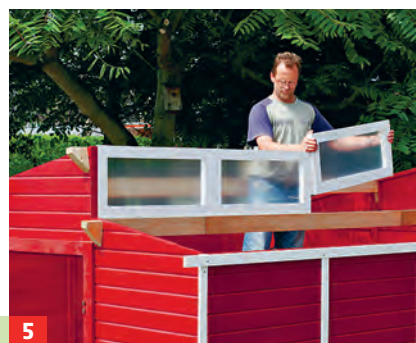
5 Die vier mit Polystyrolscheiben „verglasten“ Fensterrahmen auf die Pfette setzen und verschrauben.
