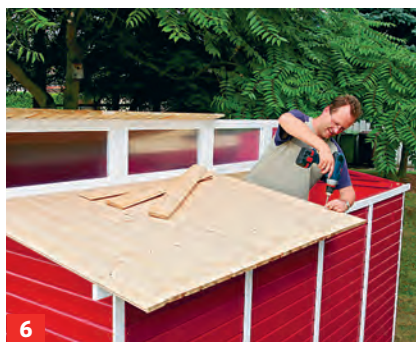
6 Nun werden die Dachplanken von der Mitte aus zu den Seiten im rechten Winkel angebracht.
