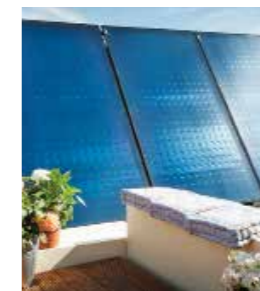
Auch auf FLACHDÄCHERN lässt sich Sonne für Warmwasser und Strom einfangen.
