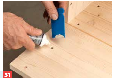
31 Nur so können die Schraubenköpfe mit einem Holzspachtel abgedeckt werden. Nach dem Trocknen schleifen.
