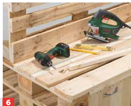
6 Sitzfläche und Rückenlehne mit sägerauem Holz auffüllen. Die Leisten müssen hierzu individuell zugeschnitten werden.
