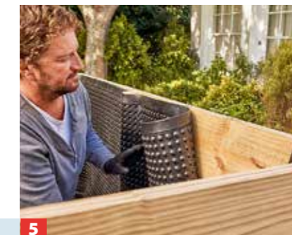
5 Damit das Holz vor permanentem Erdkontakt geschützt ist, wird innen rundum eine Drainagebahn angebracht.
