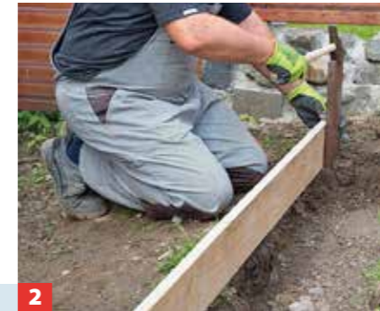
2 Damit der Beton nicht überläuft, sondern in gewünschter Höhe aushärtet, ist an einigen Stellen eine Schalung erforderlich.
