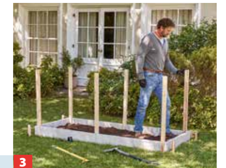
3 Nun werden die zugeschnittenen Kanhölzer in den Ecken und mittig an den langen Seiten in die Erde gesteckt.
