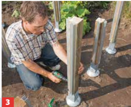
3 Die Pfosten ablängen und montieren. Dann verschrauben Sie die Aluminium-U-Profile mit den Pfosten.
