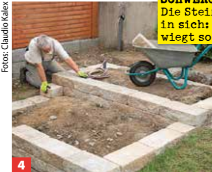
4 Die unterste Steinlage wird in ein Bett aus ausgleichendem Dickschichtmörtel gelegt, die Oberseite muss eben sein!
