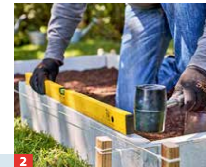
2 Für den Sockel werden Rasenkantensteine entlang der abgesteckten Fläche etwa 10 cm tief in den Boden eingelassen.
