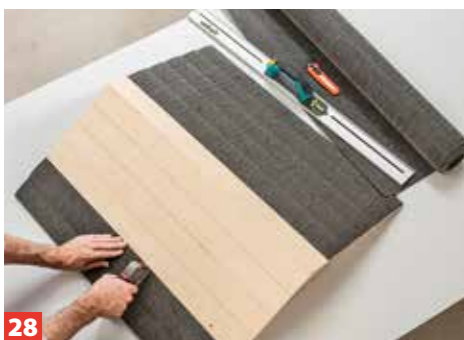
28 Das Dach haben wir mit überlappend von der Traufe zum Giebel aufgehefteten (und verklebten) Dachpappstreifen eingedeckt.
