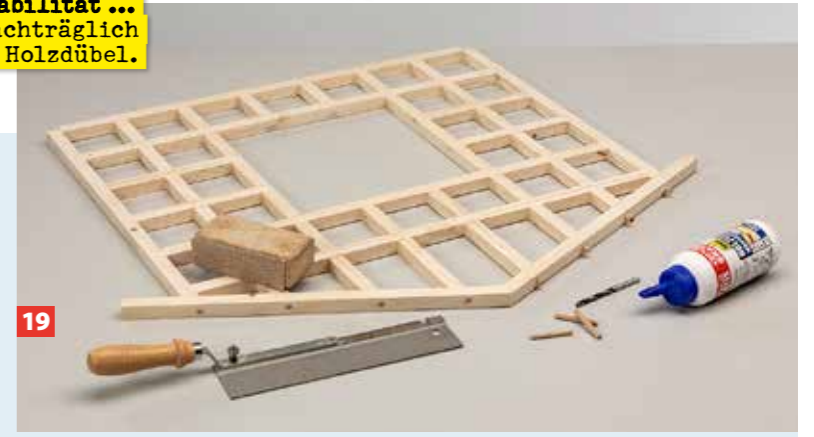
Nach dem Abbinden des Leims bohren Sie durch die Sparren in die Ständerköpfe und leimen Dübel ein. Sie werden bündig gekappt.
