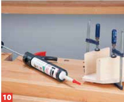
10 ... Rückwand und drücken sie an. Klebstoff angeben und verpressen. Nagelspitzen halten die Bauteile in Position.
