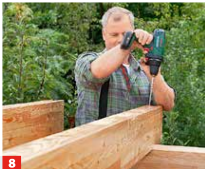
8 ... Abstand sorgen, messen Sie aber besser nach. An beiden Enden werden Quer- und Längsbalken leicht schräg verschraubt.
