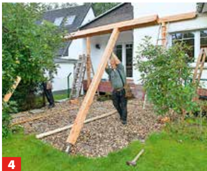
4 Die äußeren Stützbalken werden schon am Boden mit dem Querbalken „verzapft“, dann aufgerichtet und verschraubt.
