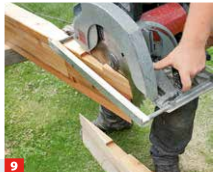
9 Da das Dach an einem Ende einen spitzen Winkel hat, müssen die letzten beiden Balken vor Ort passgenau ...
