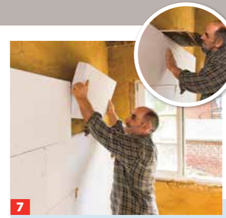
7 Platten mit etwas Druck „einschwimmen“. Stoß- und Lagerfugen nicht verkleben, Platten dicht (knirsch) aneinandersetzen.
