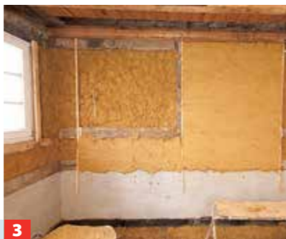
3 ... glatt abziehen. Eventuelle Unebenheiten mit Putz ausgleichen, es muss ein glatter Untergrund geschaffen werden.
