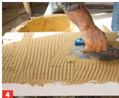
4 Außenwände kann man nun von innen dämmen. Lehmmörtel 3) , mit dem auch verputzt wird, auf die Platten 4) ziehen.
