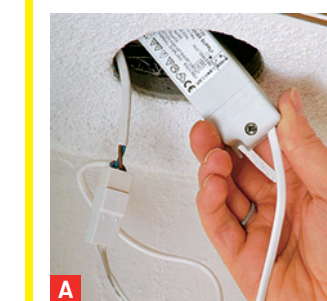
A In abgehängten Decken verschwindet der Trafo/Treiber im Hohlraum
