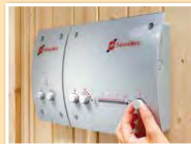
Rechts die Temperatursteuerung, links daneben das Feuchtesteuergerät.
