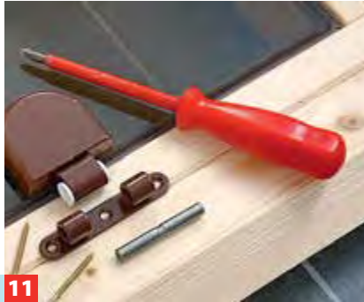
11 Es folgt das Türelement: Auf den Boden legen, die Befestigungspunkte der Scharniere ermitteln und diese verschrauben.
