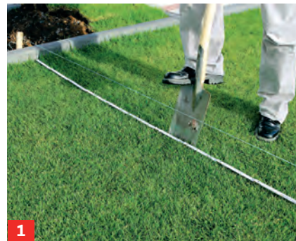
1 Den Zaunverlauf markieren, die Position der Pfosten exakt festlegen und eine Richtschnur spannen.
