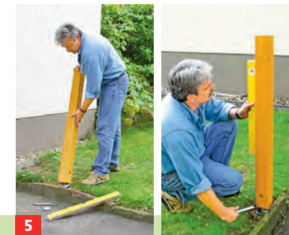
5 Pfosten auf den eingeschraubten Anker setzen, ausrichten und mit Hilfe des Schraubbolzens befestigen.
