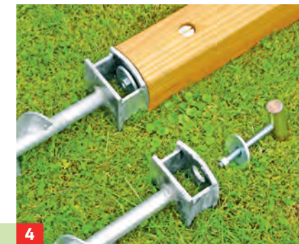
4 Die 90 x 90 mm großen Pfosten werden nun mit den verzinkten Schraubankern 85 x 85 x 750 mm verschraubt.
