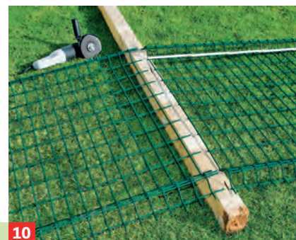
10 ... einen alten Holzpfosten unter die Gittermatte legen und diese mit dem Winkelschleifer durchtrennen.
