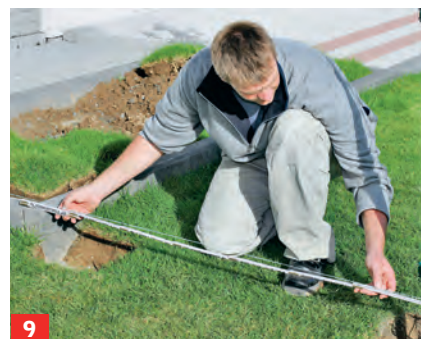
9 In diesem Fall musste ein Zaunelement in der Länge eingekürzt werden. Exakt Maß nehmen, ...
