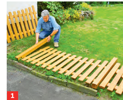
1 Alten Zaun demontieren und den neuen Lattenzaun probeweise an der gewünschten Position auslegen.
