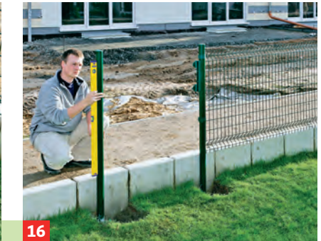
16 Die beiden Torpfosten exakt ausrichten und den Stand mit der Wasserwaage kontrollieren.
