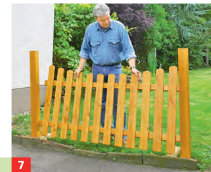
7 Stehen die Pfosten absolut senkrecht (mit der Wasserwaage prüfen), lassen sich die Zaunelemente einsetzen.
