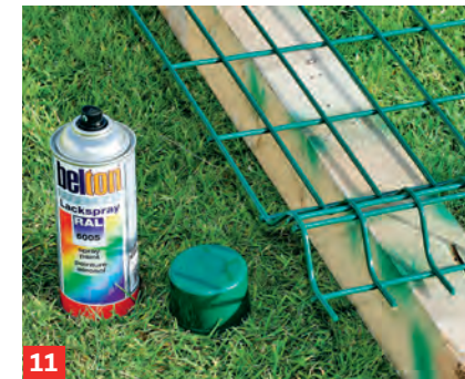
11 Die Schnittstellen sollten mit Lack-spray geschützt werden, in diesem Fall Farbnummer RAL 6005.
