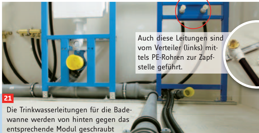
21 Die Trinkwasserleitungen für die Badewanne werden von hinten gegen das entsprechende Modul geschraubt
