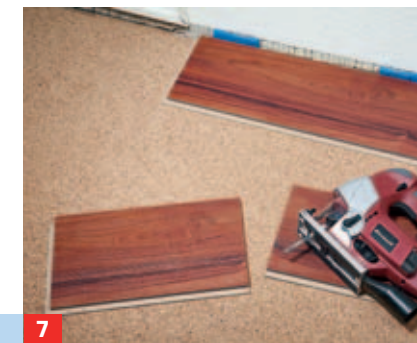
7 Schnittlinie am 90,5 cm langen Element markieren und es von der Rückseite aus durchschneiden.
