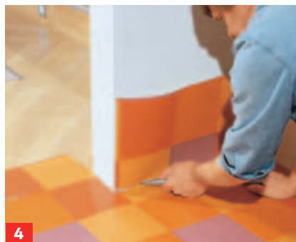
4 ... den Belag umknicken, fest in die Ecke zwischen Wand und Boden drücken und bündig abschneiden.
