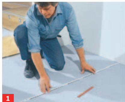
1 Vorm Kauf den Raum in beide Richtungen ausmessen; Türzargen und Heizkörpernischen berücksichtigen!
