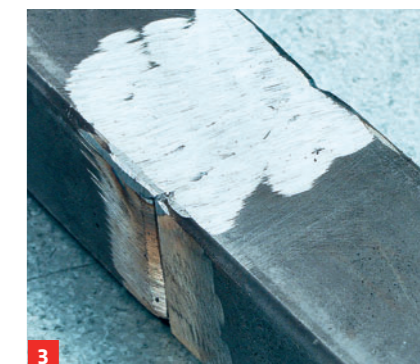
3 ... Schichten ist kaum noch ein Übergang im Material erkennbar
