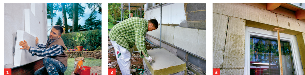
1. Auf einer Sockelschiene ruhen die Dämmplatten. Sie werden erst mit ... 2. ... der Wand verklebt. Auch den Sockelbereich unter der Schiene dämmen! 3. Am Fenster und an Dachuntersichten vorkomprimierte Dichtbänder einsetzen
