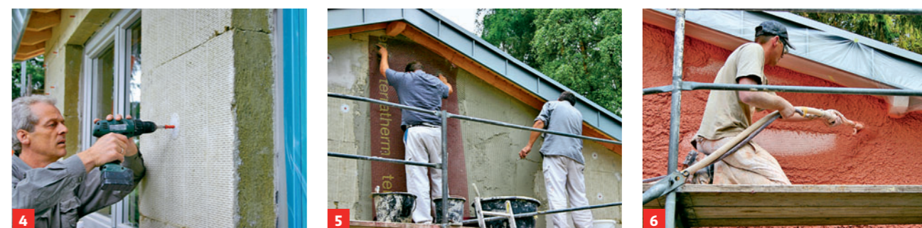
4. Alle Dämmplatten werden dann verdübelt – das kann man gut selbst 5. Das Verputzen von Dämmplatten sollte man Profis überlassen. Sie ... 6. ... betten Gewebe ein, verspachteln und verputzen die gesamte Fläche
