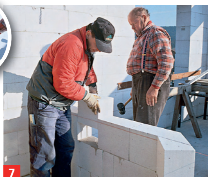
7 Diese bis zur Hälfte umklappen und in die Innenwand einbinden. Passstücke mit einem Fuchsschwanz zuschneiden
