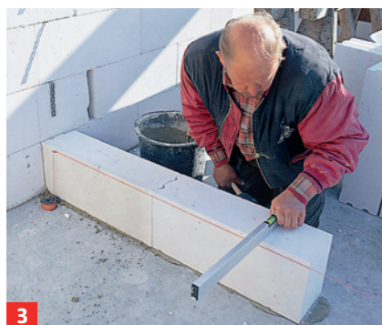
3 Die erste Schicht – hier eine Innenwand – stets in Dickbettmörtel setzen und mittels Wasserwaage ausrichten
