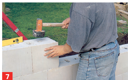
7 Mit dem Gummihammer klopfen Sie die eingesetzten Steine fest. Kontrollieren Sie stets die Mauerflucht
