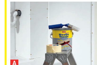
A Spanplatten anschleifen, als Haftvermittler für den Putz unbedingt eine Grundierung auftragen! Den Putz ...
