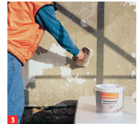
3 Absandende Bereiche sollte man mit Tiefgrund behandeln, den man mit Quast oder Farbbrolle aufträgt
