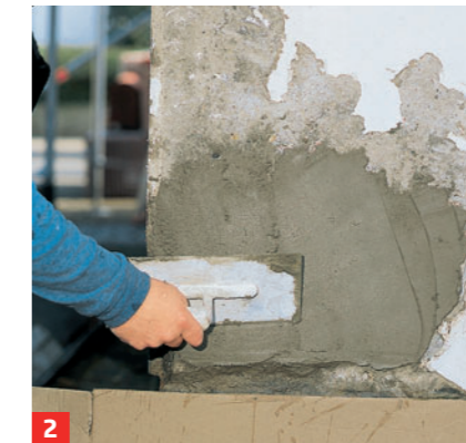
2 Fehlstellen mit Kalkzementmörtel, zum Beispiel mit Universal-/Reparaturmörtel, großflächig ausbessern
