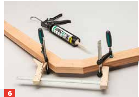
6 ... stecken Sie die Dübel ein und dann die Bauteile zusammen. Mit zwei Hilfszwingen und einer Spannklemme verpressen.
