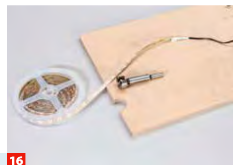
16 Es folgt der Zuschnitt der Zwischen-/Außenwand. Hier müssen Sie für das Lichtband bodenseits eine Aussparung schneiden.
