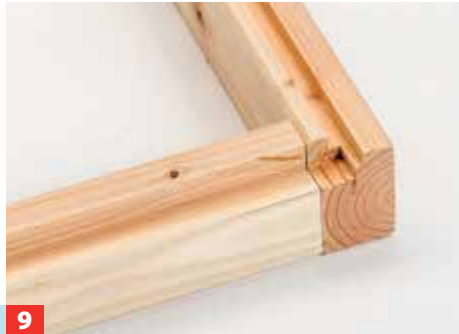
9 So sollte nun die linke, untere und nach innen zeigende Frontecke aussehen – und spiegelverkehrt ebenso die rechte Ecke.
